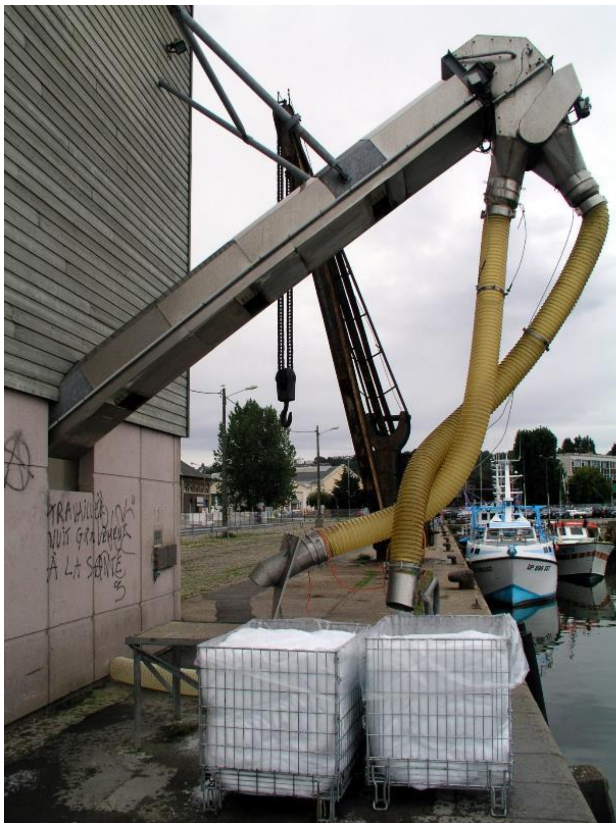
Slika 13 Postrojenje za proizvodnju leda
