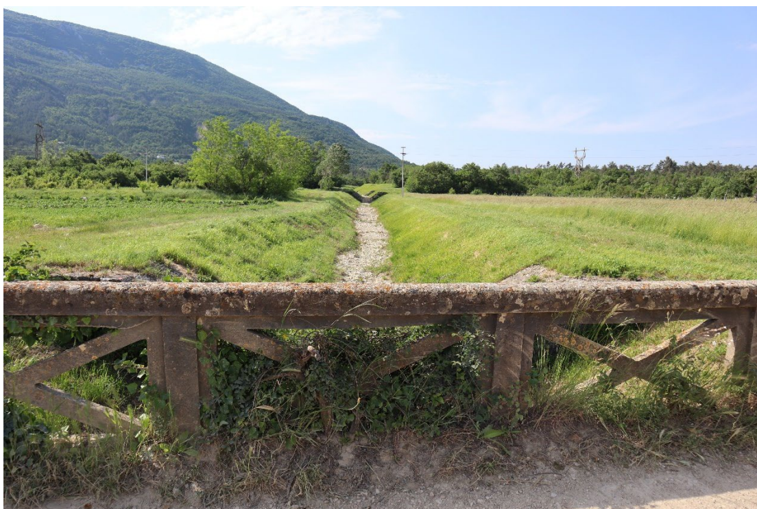
Slika 19 - Odvodni kanal u Čepićkom polju (Autor: 3E PROJEKTI d.o.o.)
