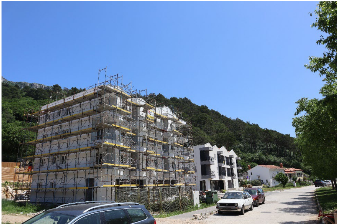
Slika 155 – Devastacija obalnog pojasa novom stambeno-poslovnom izgradnjom u naselju Plomin Luka (Autor: 3E PROJEKTI d.o.o.)
